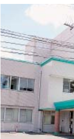
本庄内科病院。建物の一部(写真右側)が地震被害を受け、建て直された
