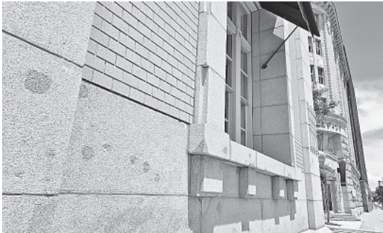
旧居留地の海岸ビルに残る機銃掃射の銃弾跡
